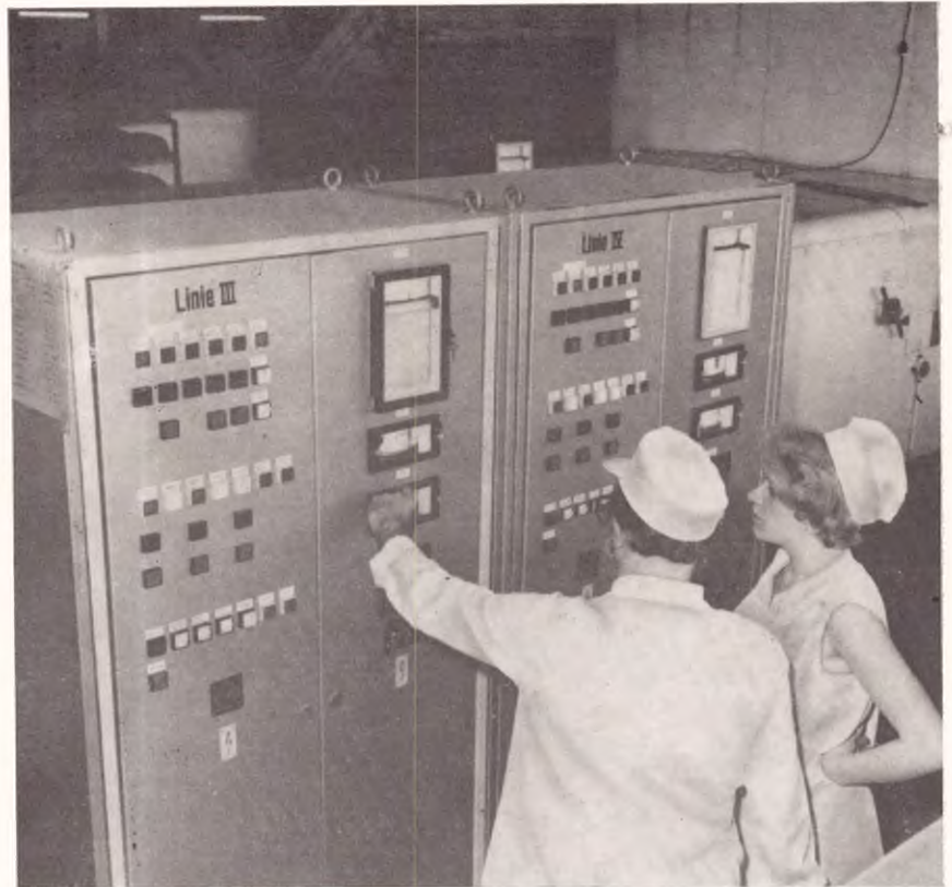
Schaltschränke für 2 Ofenlinien
