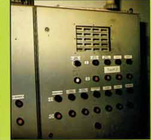
Schaltschrank mit Zählwerk für die Einzelarbeitsplätze
